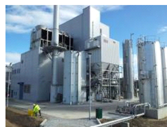
La centrale en cogénération à biomasse d'Helius CoRDe une mise en service réussie
