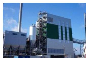
Biolacq, -une centrale cogénération de 54 MW en France.
