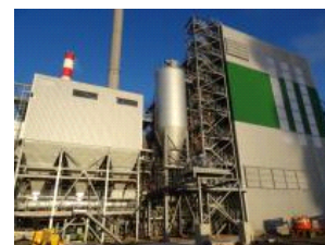
Le projet Biolacq Energies, à Lacq, est une centrale de cogénération à biomasse d'une
