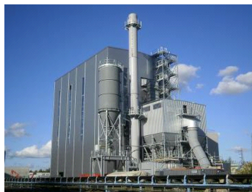
Bio Cogelyo Normandie (BCN) en France est une centrale de cogénération à la biomasse avec un apport annuel de combustible de 165.000 tonnes de biomasse.
