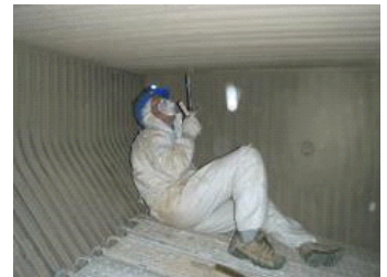
Inspection de la Chaudière et du système de combustion
