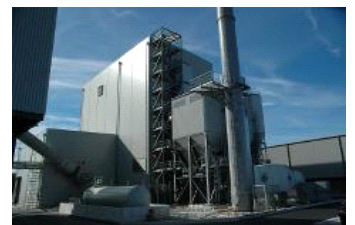
Centrale électrique Western Wood, Pays de Galles - Royaume Uni
