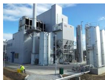
La centrale CHP Roths CoRDe en Écosse produit 8,0 MW de chaleur et 8,4 MWe d'électricité.
