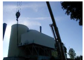
La centrale CHP de Schneider Biopower en Allemagne
