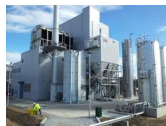
Roth's CoRDe CHP Plant, l'Écosse.
