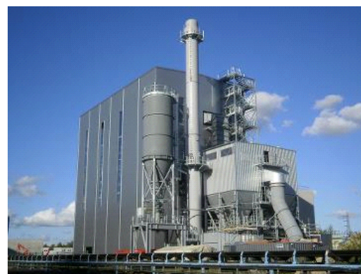
Bio Cogelyo Normandie (BCN) en France est une centrale de cogénération à la biomasse avec un apport annuel de combustible de 165.000 tonnes de biomasse.
