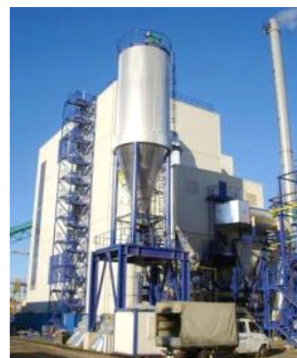
Fundermax Biomasse Energieanlage est une centrale de cogénération à la biomasse chaleur-électricité (CHP) située à Neudörfel, en Autriche.
