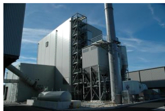
La centrale électrique Western Wood à la biomasse produit 15 MWe d'électricité.
