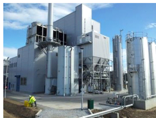
Heliuss CoRDe Ltd est une centrale de cogénération à la biomasse, alimentée par un produit dérivé de la fabrication du whisky et par du bois propre. La centrale a été mise en service en 2013.
